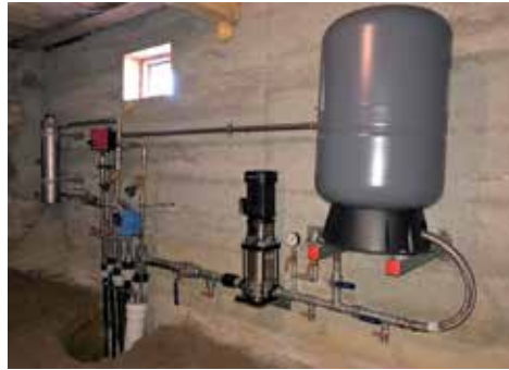
Neue UV-Anlage im Keller
